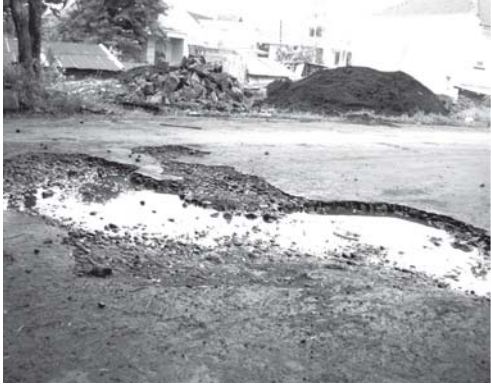
>>Kondisi jalan yang sudah rusak hingga saat ini belum mendapat perhatian sama sekali.
